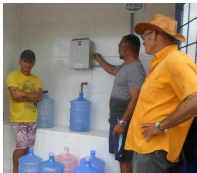
Retirada de água dessalinizada em um chafariz eletrônico - Comunidade de Várzea Município de Jaguarari (MAIO/2018)
